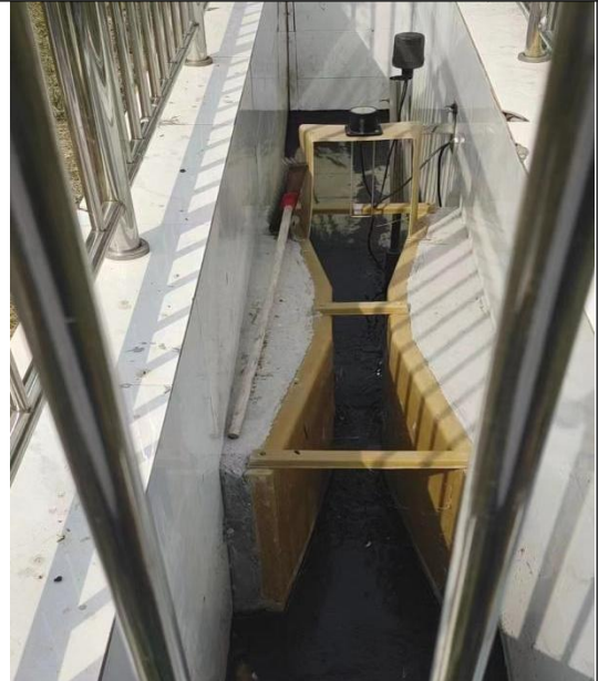
峰城区中医院污水处理站总排口
