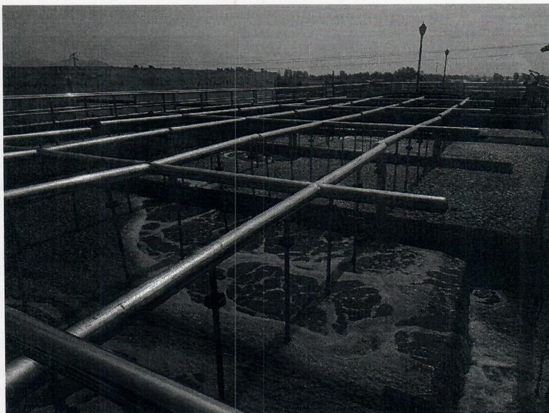
阴平镇污水处理厂设施运行正常
