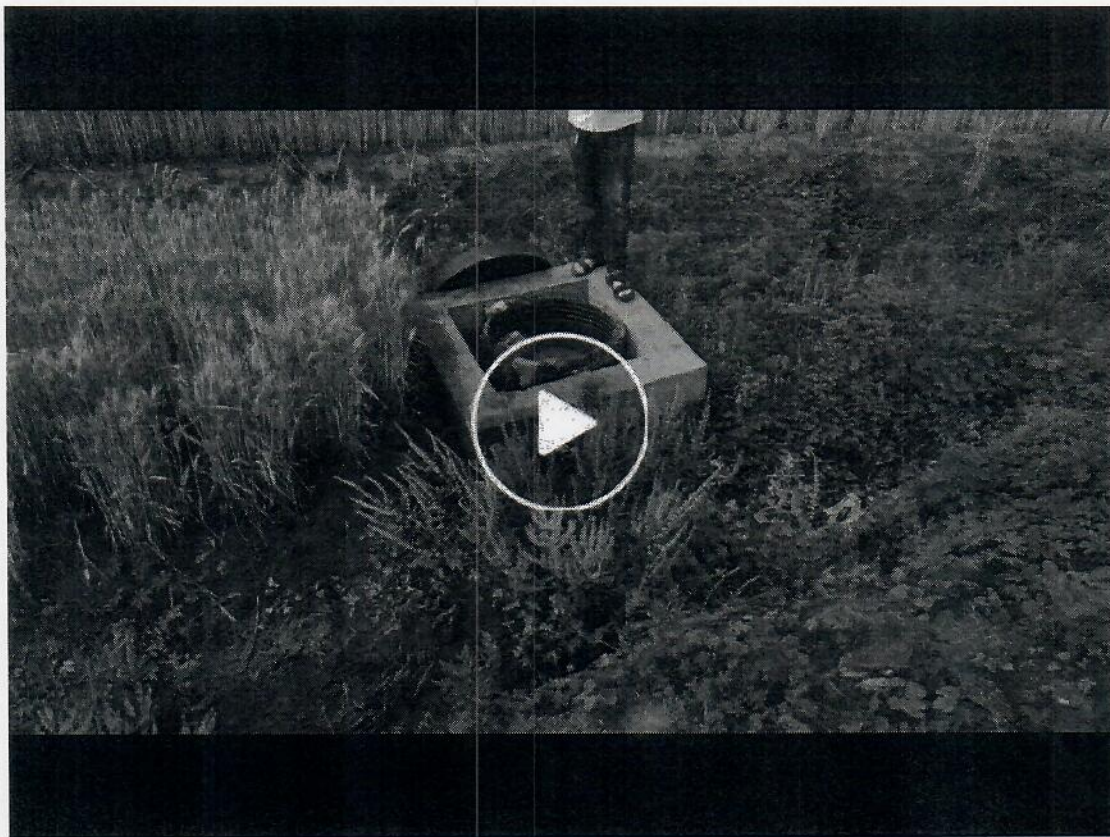
检查井外溢点
