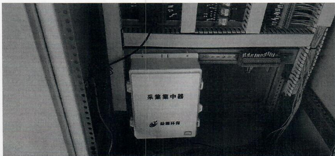
阴平镇污水处理厂用电监控设备
