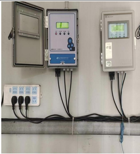
峰城区中医院污水处理站在线监测设备
