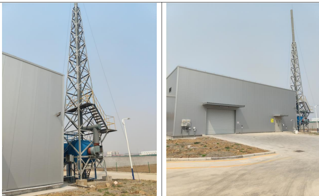
厂区现有危废暂存间废气治理设备
